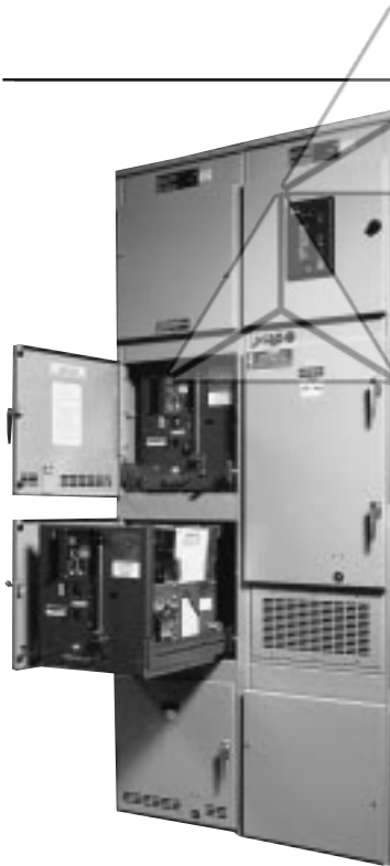
DS Switchgear Assembly
